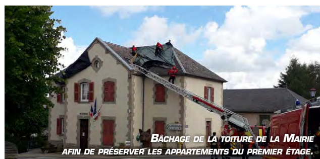
GOUTTIÈRES : MOBILISATION DE TOUTS LES SAPEURS POMPIERS DU DÉPARTEMENT.
