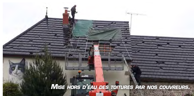
BÂCHAGE DE LA TOITURE DE LA MAIRIE AFIN DE PRÉSERVER LES APPARTEMENTS DU PREMIER ÉTAGE.
